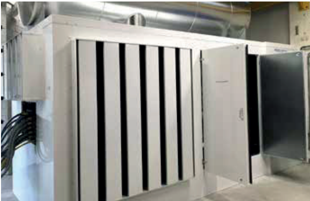
Aggregaat met een vermogen van 1.700 kVA door ABATO Motoren geleverd en geplaatst tijdens de renovatie van de Velsertunnel.
